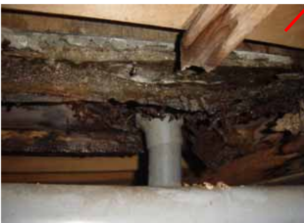
矢印の箇所の中の状態です。 中の木材部分が湿気で腐っています。
